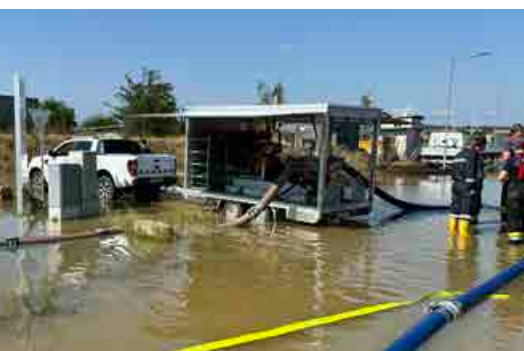
Vogelsang-Pumpen im Einsatz bei der Hochwasserkatastrophe
