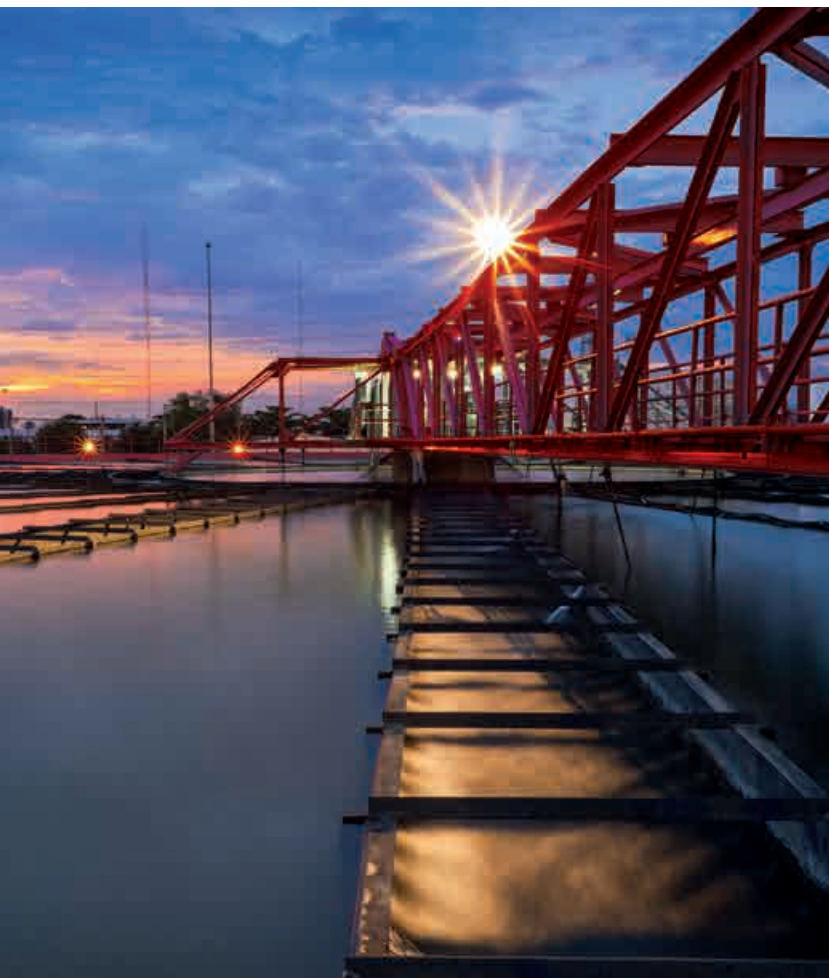
Abendstimmung in der Kläranlage
